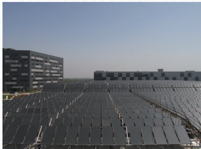
杭州光伏發電系統
