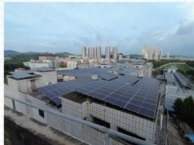
東莞光伏發電系統
