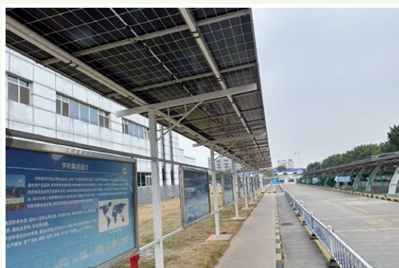
圖：南寧東盟伊利分佈式光伏項目
