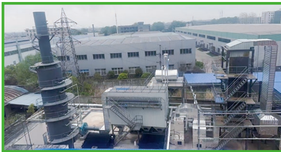
圖：揚中油坊鎮新材料工業園生物質能清潔供熱項目
