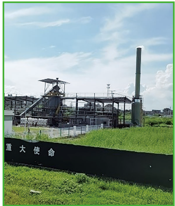
圖：漳州中燃新能源科技有限公司生物質清潔供熱項目
