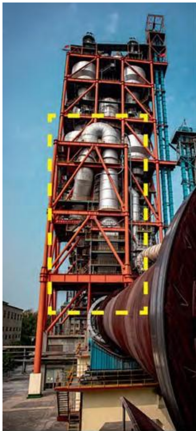
衛輝市天瑞水泥有限公司脫硝設施
