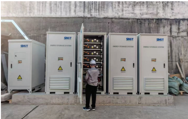
東莞大嶺山工業園區工商儲能項目
